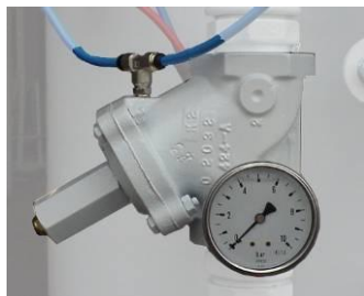
Ventil glavnog vazdušnog voda
