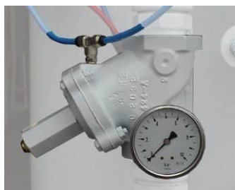
Ventil glavnog vazdušnog voda
