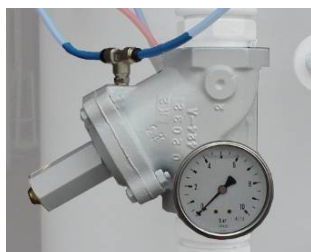
Ventil glavnog vazdušnog voda
