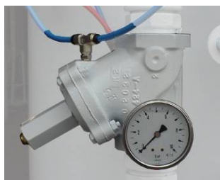
Ventil glavnog vazdušnog voda
